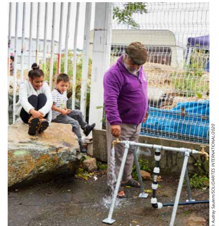
Un raccordement en eau potable près du campement de Saint-Domingue.
